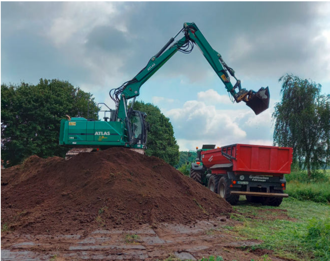
Große Erdmengen müssen bewegt werden Bild linke Seite: Praxisnaher Unterricht direkt am Wasser
