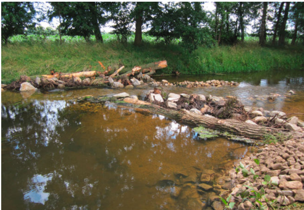
Einengung des Abflussquerschnitts mit leichter Anhebung des Wasserspiegels und Wiederaanbindung eines Altarmes Bild linke Seite: Umgestalteter Gewässerabschnitt Beverstraße
