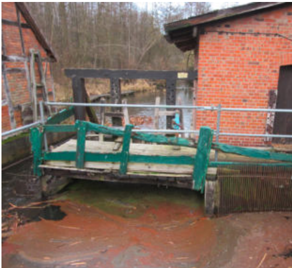
Abgängige Wehranlage vor Beginn der Maßnahmen
