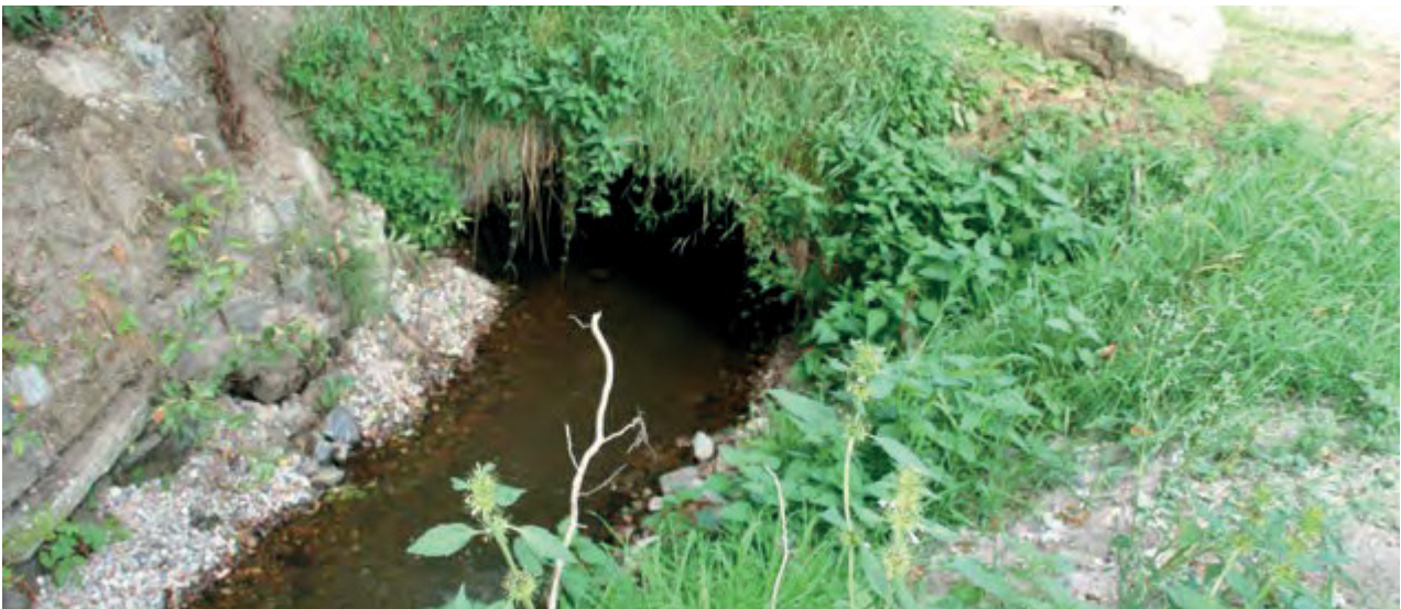
Großzügiger Hamco-Durchlass im renaturierten Gewässerlauf
