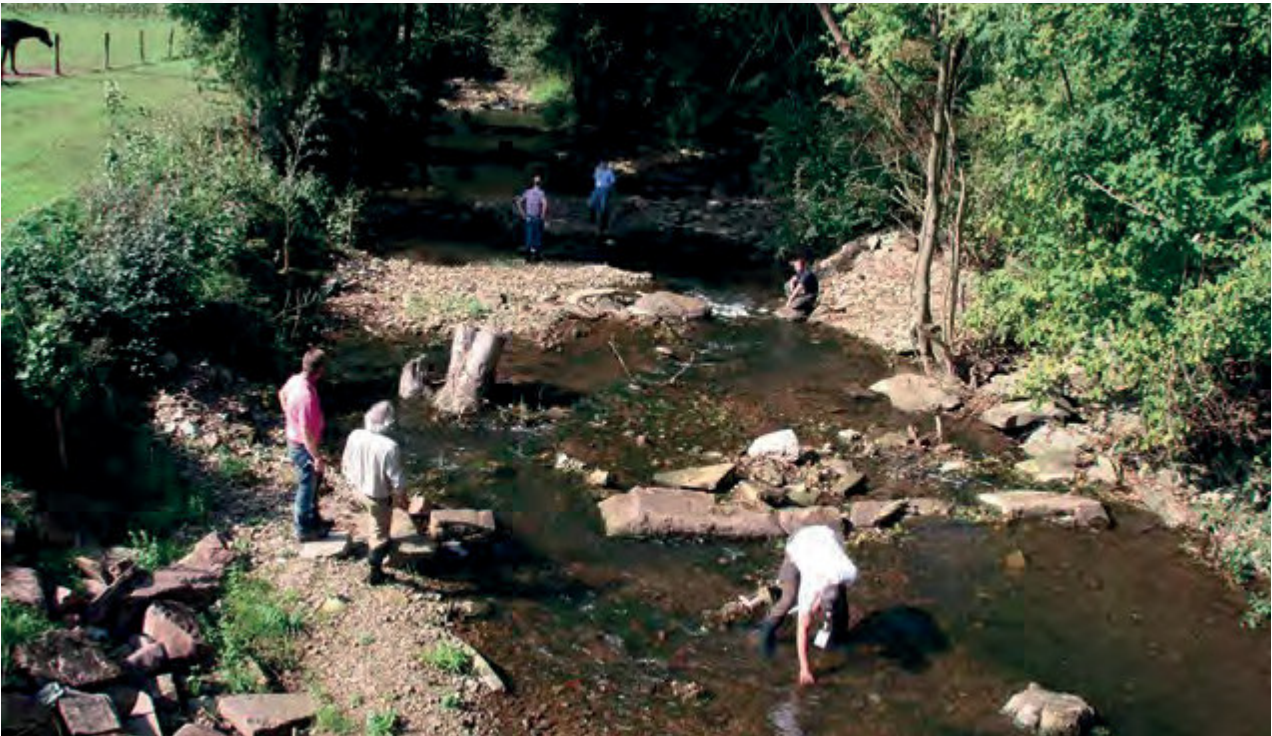
Beeindruckender Rückbau eines Wehres zu einer ökologisch vorbildlichen und zudem landschaftlich ansprechenden Sohlgleite
