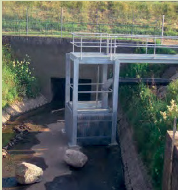
Basbecker Schleusenfleth - Lockstrompumpe
