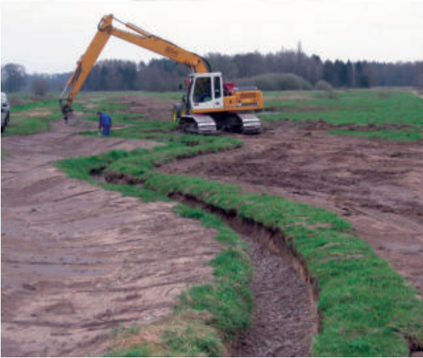
Einbau von Sohlsubstrat ins geformte Bachbett dient der Wiederherstellung des Lückensystems in der Sohle.
