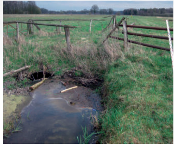
Ausgangszustand: Sohlabsturz kurz vorm Durchlass
