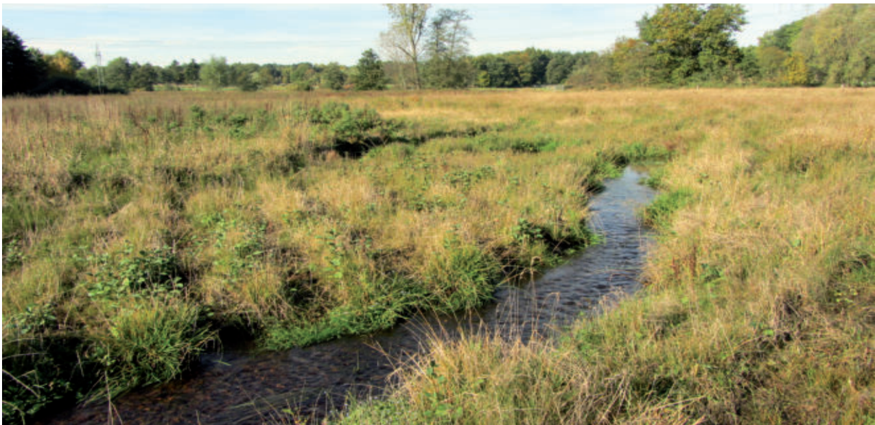
...und im Spätsommer - ein Jahr nach Baubeginn - ist der Bach bereits eingegrünt
