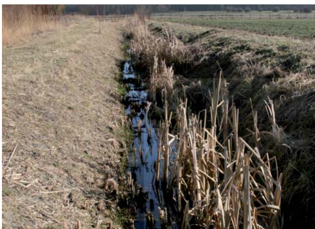
Bei alleiniger Böschungsmahd wird insbesondere der Mittelwasser-Abfluss beeinflusst. Bei hohen Abflüssen sorgt die freie Böschungsschulter für hohe hydraulische Leistung. (Foto: U.A.N.)
